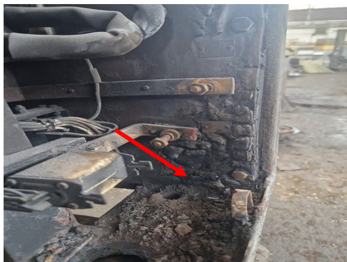
Фиг. 4.11. Опожарена изолационна дъска.
