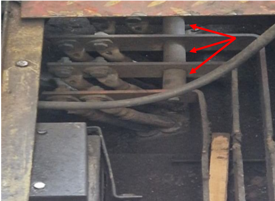
Фиг. 4.10. Силови кабели на второ клемно табло на тяговия двигател с изолационни втулки.
