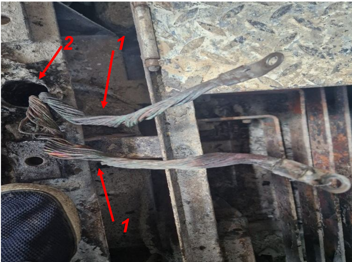
Фиг. 4.9. Силови кабели на втори двигател компресор 235.
