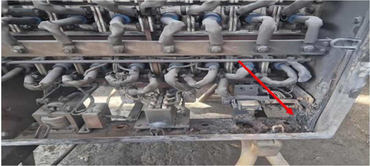
Фиг. 4.8. Опожарен тягов токоизправител 022.
