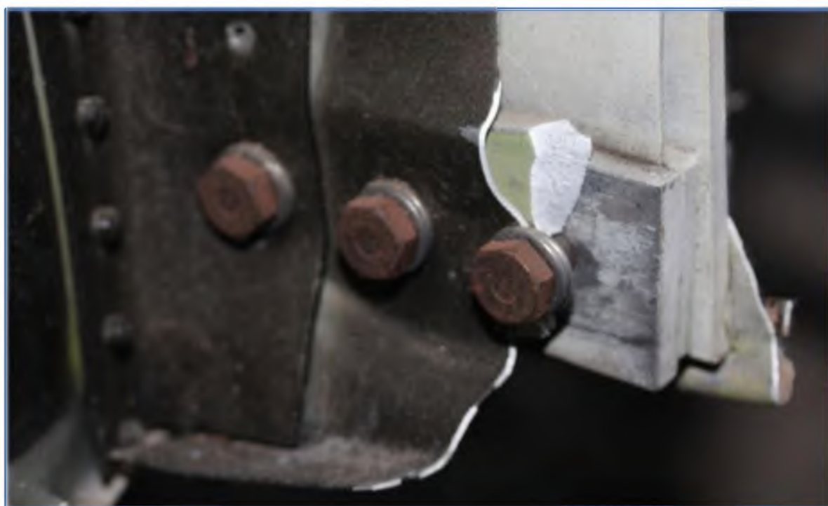
Фиг.2.9 Свързващи болтове (3 бр.) на горния пояс на надлъжника на лявото полукрило към тялото ( крилото е обърнато ).
