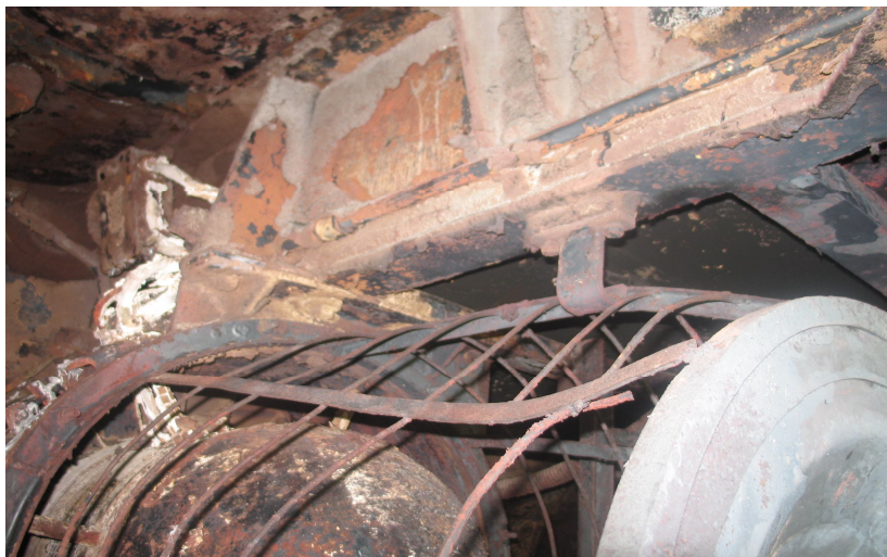
Опожарения хоризонтален подкошов вентилатор
